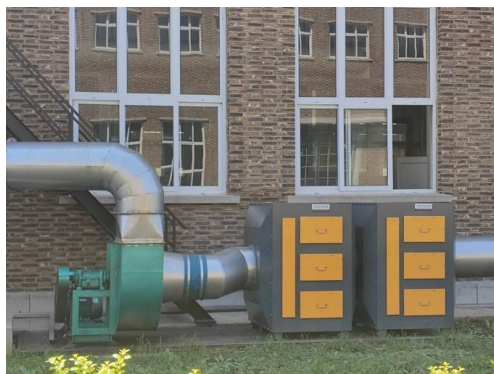
防镀剂调配、刷涂工序治理设施
